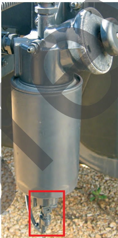
Figura 69: Sensore presenza acqua sul prefiltro
